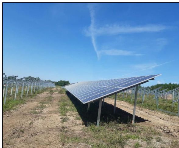
Figure 13 : Exemple de structures porteuses utilisées (Source : TECHNIQUE SOLAIRE)
